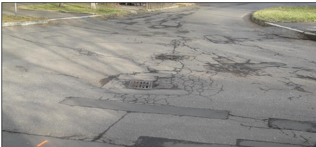
Obr. 3. Deformace vozovky v podobě prasklin a poklesů v blízkosti dešťové vpustě a revizní šachty, rovněž jsou patrné starší opravy vozovky
