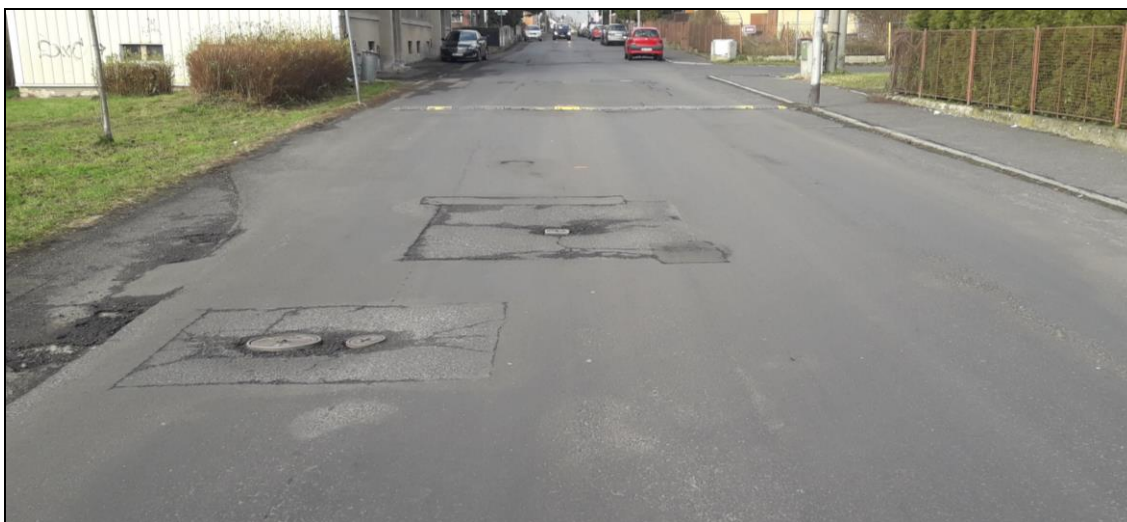
Obr. 1. Sokolov – ulice Slovenská na fotografii jsou patrné deformace v místech vodovodních a plynových uzávěrů
