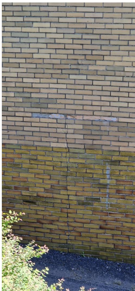
Obrázek č. 2 – poškození stěny
