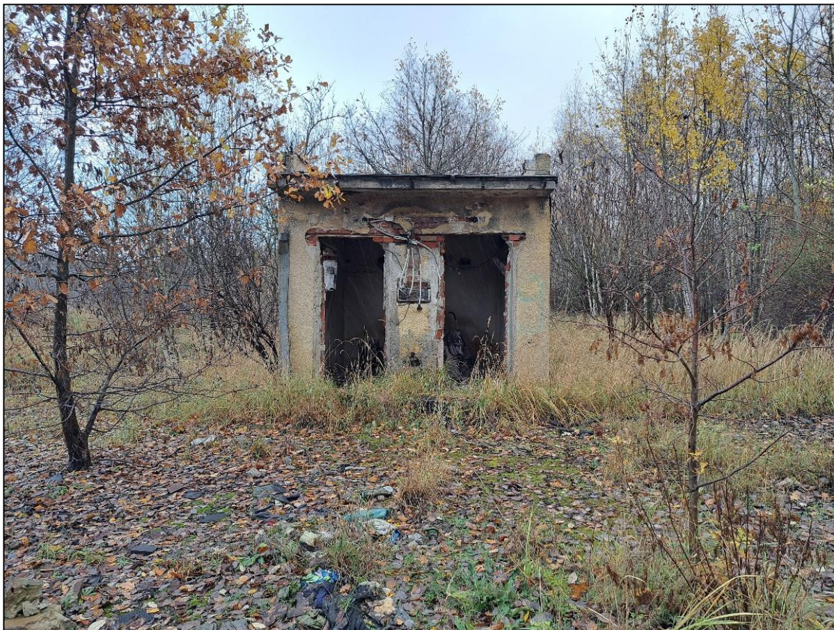
Foto č. 11 - Objekt č. 15. DKV přečerpávací stanice
